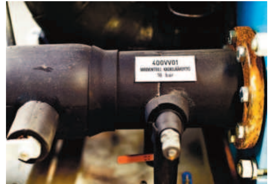
Kaukojäähdytyksen myötä myös hotellin hukkalämmöt kerätään nykyisin talteen.
