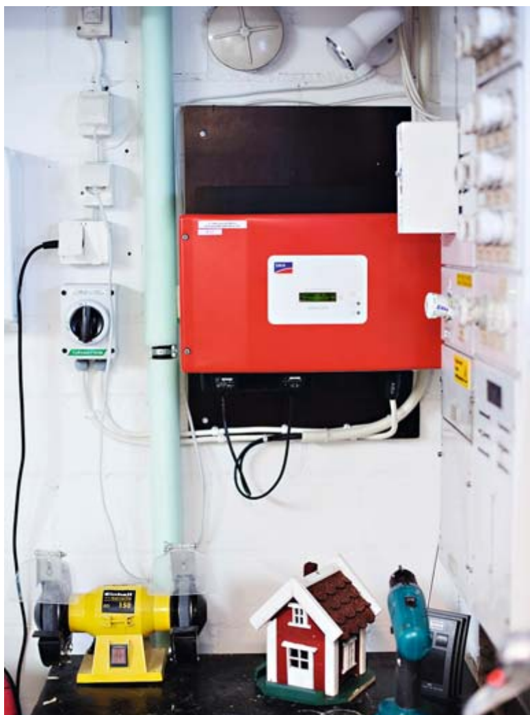
Invertteri muuntaa paneelien tuottaman tasasähkön vaihtosähköksi.
