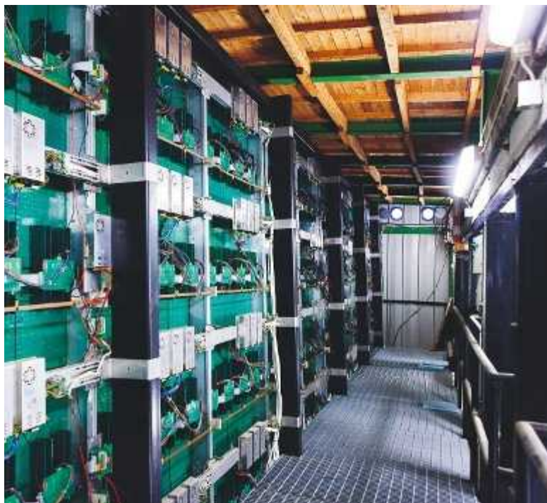
Jäähdytystä tarvitaan erityisesti teknisissä tiloissa ja toimistoissa.
