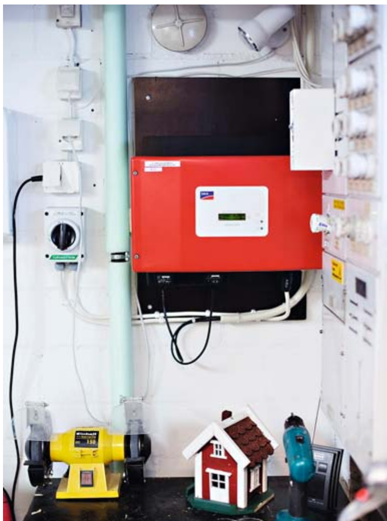
Invertteri muuntaa paneelien tuottaman tasasähkön vaihtosähköksi.
